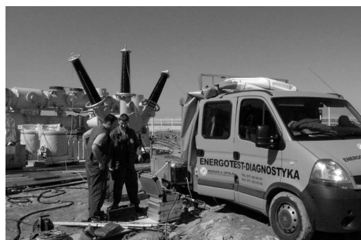
Rys. 9. Badania pomontażowe rozdzielni 110 kV typu GIS SF6, w zakładach produkcyjnych LG pod Wrocławiem
