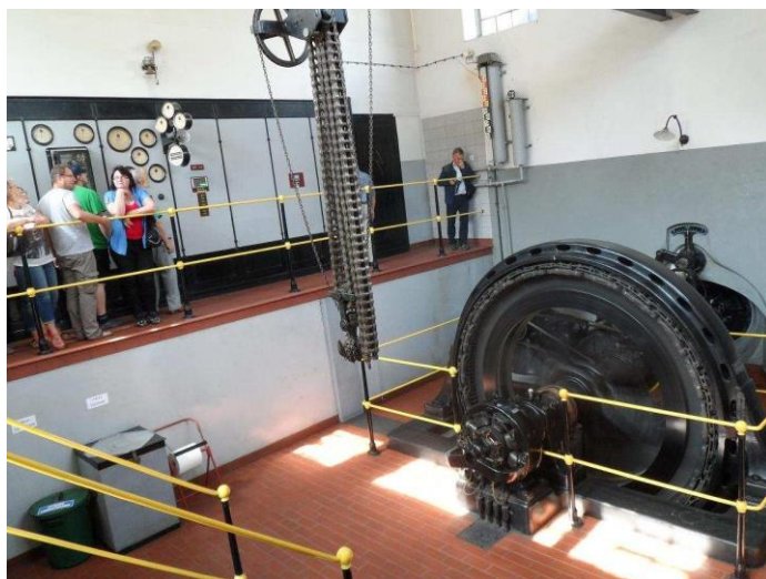
Fot. 4 - w Małej Elektrowni Wodnej
