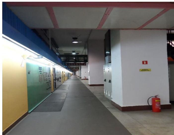
Fot. 2. Wnętrze elektrowni.
